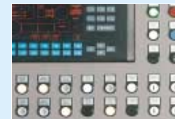
SPS für die automatische Steuerung.
